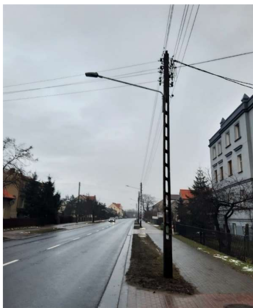
Oprawy ledowe przy ul. Głównej w Serbach
