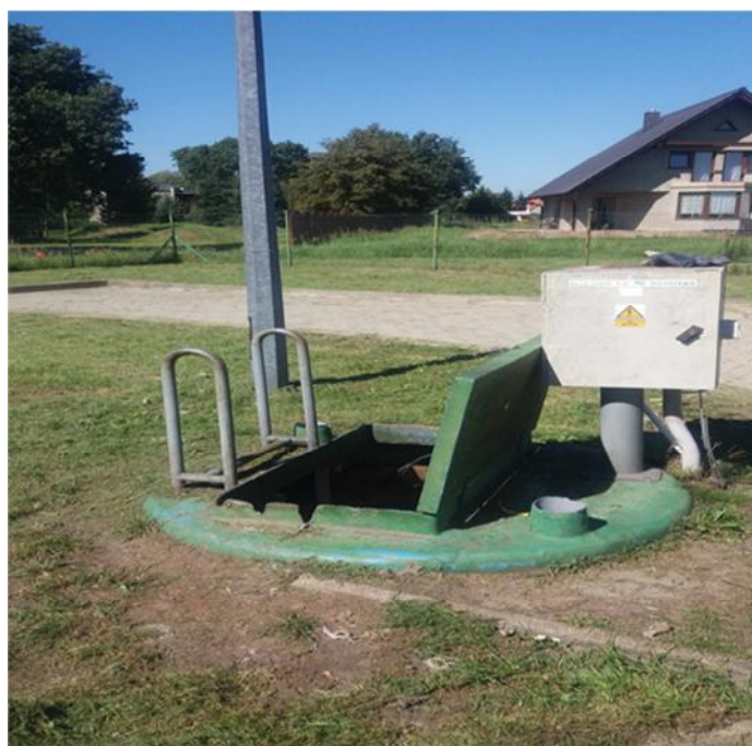
Rys. 7. Stan techniczny przepompowni przy ul. Brzozowej
