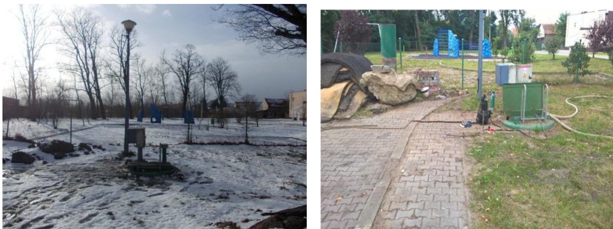
Rys. 6. Stan techniczny przepompowni przy ul. Wałowej
