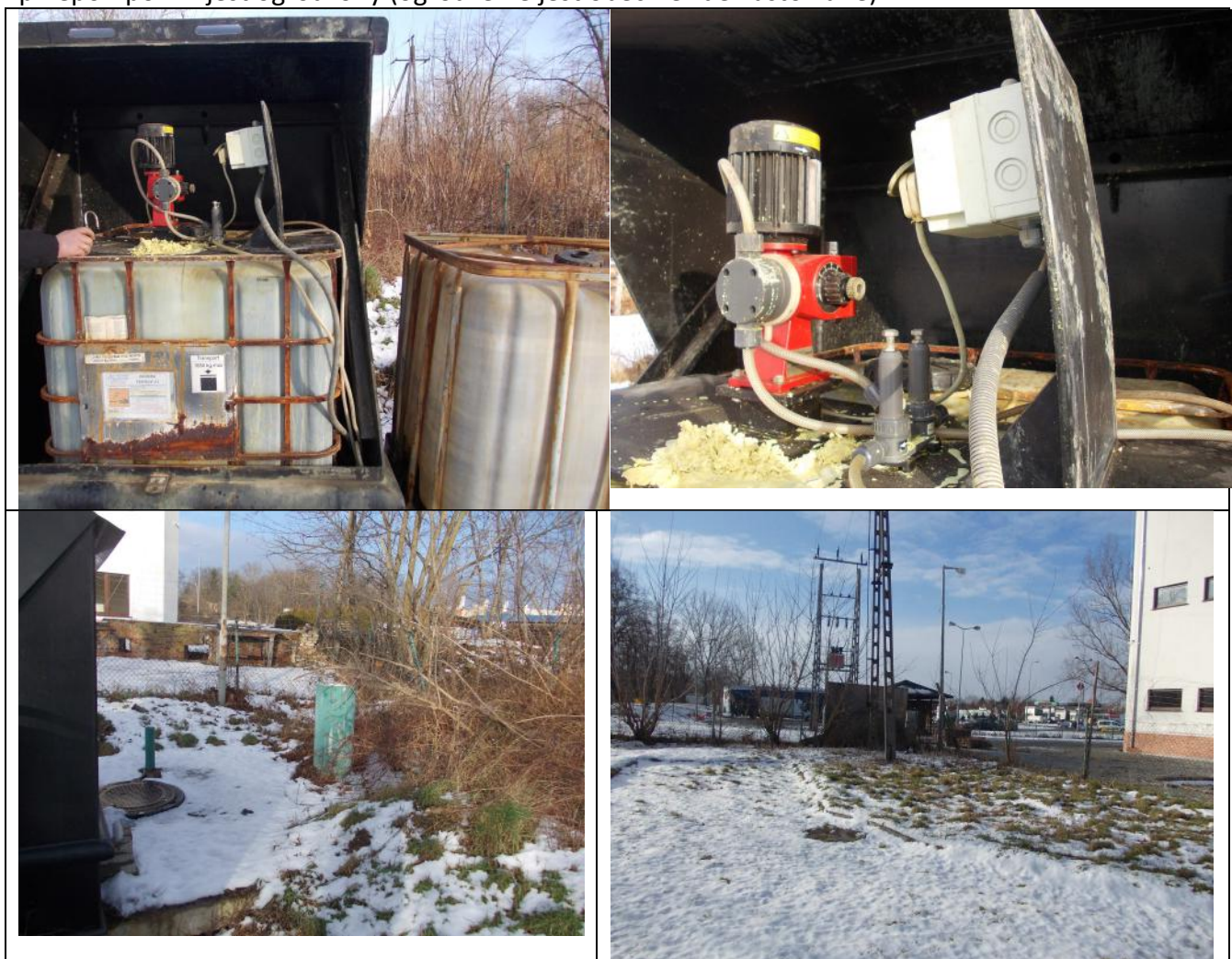
Rys. 2. Stan techniczny przepompowni przy ul. Głównej
