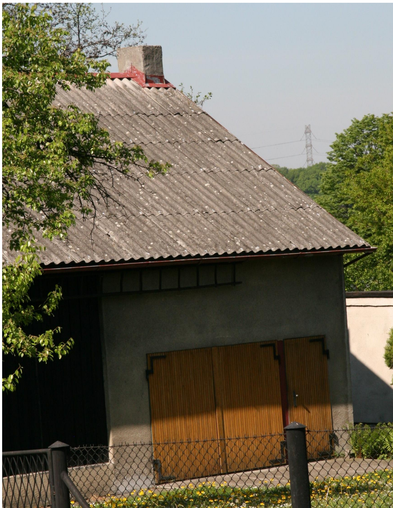
Rysunek 4 Dach pokryty płytami azbestowymi falistymi
